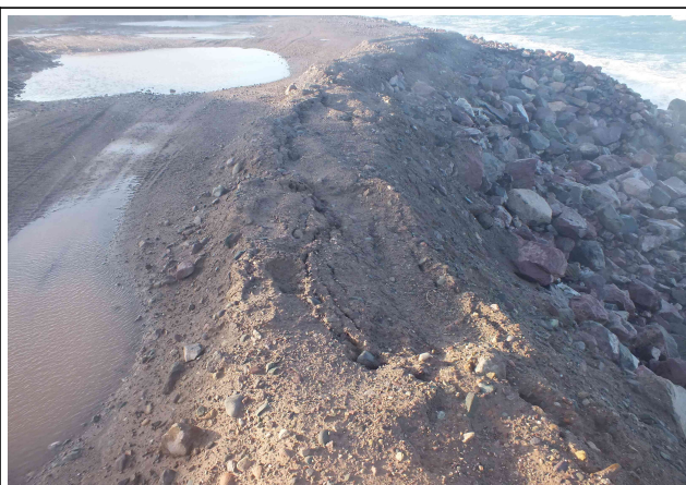
Affaissement du merlon sur effondrement central
