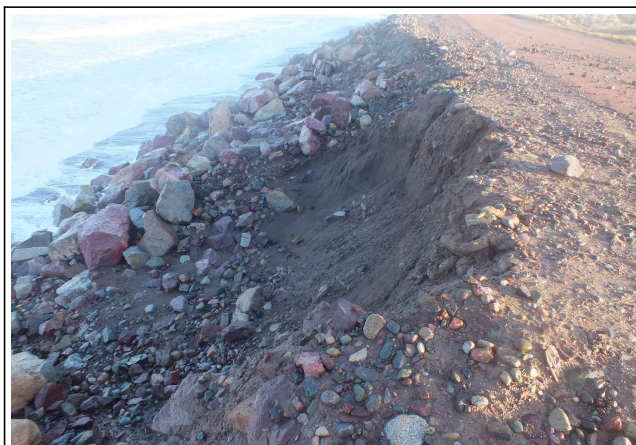
Effondrement amont (digue)
